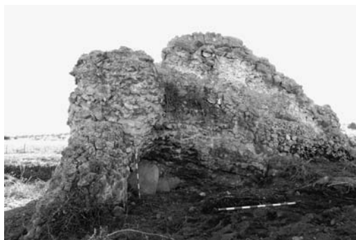
Figura 2 Contrafuerte arruinado visto hacia aguas arriba (Arenillas et al. 2009)
