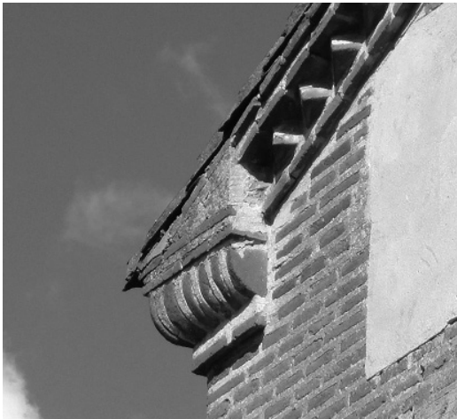
Figura 12 Encuentros entre aleros de la fachada principal y el testero lateral.
