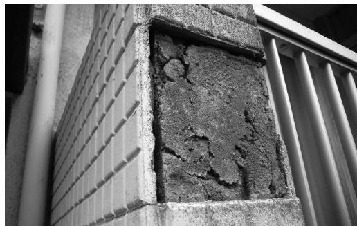
Figura 6 Desprendimiento de una baldosa hidráulica por pérdida de adherencia del mortero de agarre. Edificio de 16 viviendas situado en la calle Parke, 5-7 del municipio de Errenteria, proyectado por Francisco Antonio Zaldua en 1960. (fotografía del autor)
