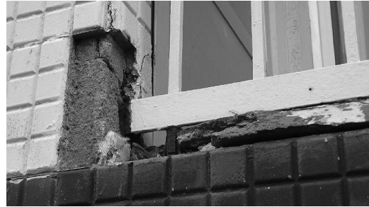
Figura 8 Desprendimiento de parte del revestimiento del suelo y del antepecho por estallido de la zona de anclaje de la barandilla. Edificio de 16 viviendas situado en la calle Parke, 5-7 del municipio de Errenteria, proyectado por Francisco Antonio Zaldúa en 1960. (fotografía del autor)
