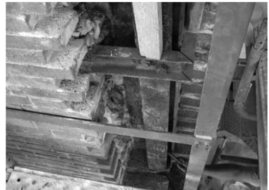
Figura 8 Cala efectuada sobre el punto B, donde aparecen los perfiles L120 verticales documentados ampliamente en planos de archivo. La oxidación en este caso era considerable, aunque sin pérdida de sección resistente importante. (C. Sanmartí)
