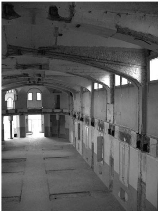
Figura 9 Planta baja del pabellón de San Manuel. El techo está formado por arcos rebajados que soportan a las bóvedas de generatriz recta. (B. Onecha)
