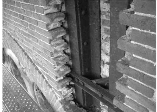
Figura 7 Cala efectuada sobre el punto A, donde quedan a la vista los perfiles IPN120 verticales, el zuncho formado por una UPN100 y el arranque de los tirantes diagonales, detalle documentado ampliamente en planos de archivo. (C. Sanmartí)
