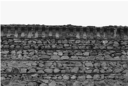
Figura 10 Detalle del alzado exterior del muro norte de la nave de la iglesia
