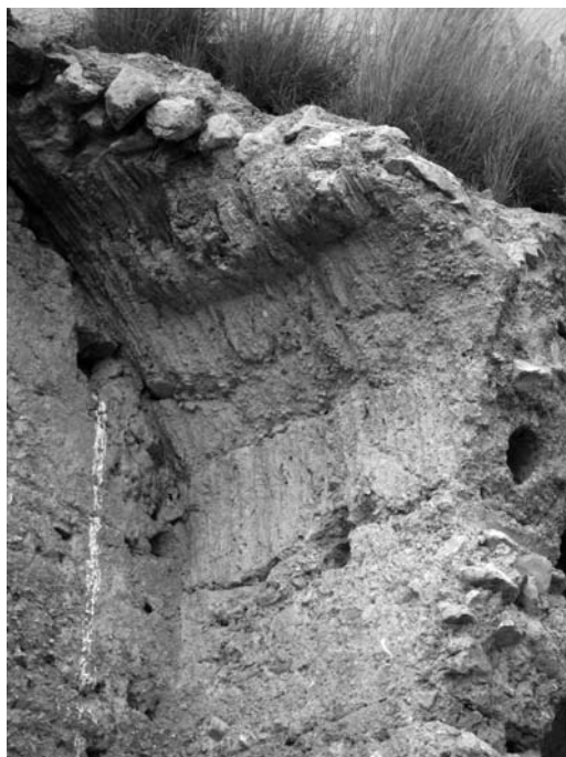
Figura 10 Restos de la bóveda de cañón apuntada del espacio interior habitable de la torre, en la que se puede apreciar la técnica constructiva empleada
