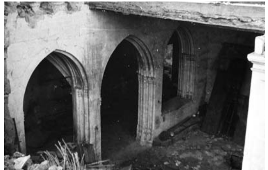
Figura 6 Detalle de la puerta de entrada a la sala capitular durante los trabajos de demolición efectuados en los años setenta
