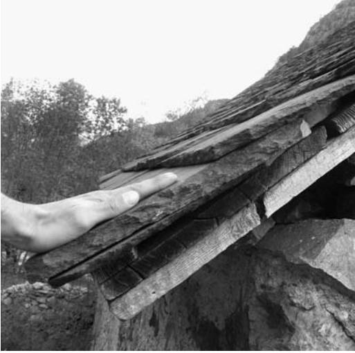
Figura 8 Losas de pizarra de gran tamaño y grosor en la parte inferior de la cubierta de una borda
