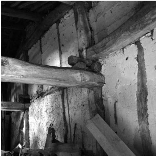
Figura 5 Relleno del entramado de un tabique interior realizado sólo de pasta de yeso. Se ejecutaba utilizando encofrado sujeto a las maderas. Se pueden ver las marcas horizontales que ha dejado el encofrado en el yeso. (Fotografía de los autores)
