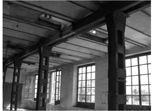
Figura 10 Pilares con perfiles empresillados de acero laminado en Fábrica de San Isidro
