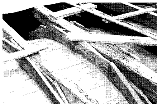
Figura 4 Vista de la parte superior de las cerchas paralelas sujetas a las vigas madres. Se aprecia la parte superior del intrados y restos del lienzo que sellaba las uniones
