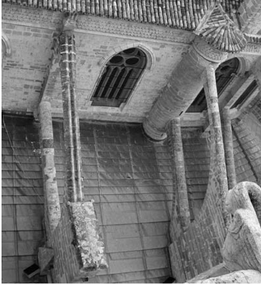
Figura 6 Vista de la cubierta de la girola baja y la nave central desde la torre (foto de los autores 2003)
