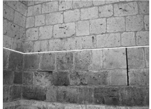
Figura 7 Muro exterior con la línea de puntos discontinuos que indica la ruptura en la continuidad de la obra. (Alonso Ruiz, 2013)
