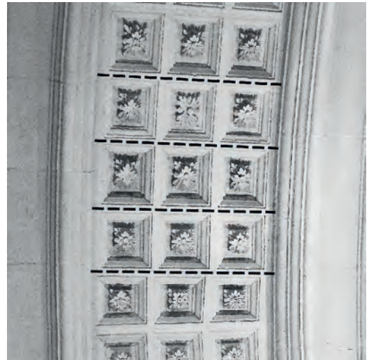
Figura 9 Despiece de los tramos con casetones, con las juntas entre dovelas remarcadas con líneas discontinuas
