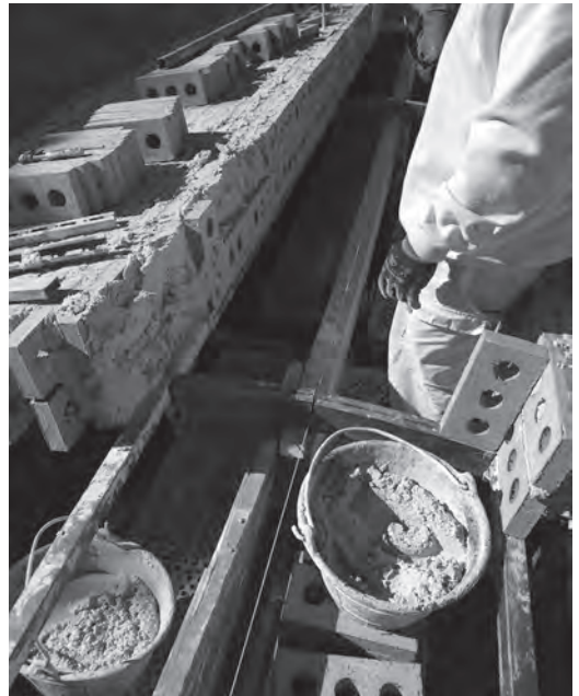
Figura 13 Hilada alta de tramo en construcción. Se aprecian tanto el aparejo como las reglas y cimbras de apoyo provisional y replanteo. Foto: C. Martín
