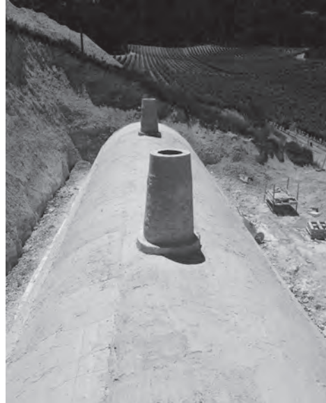
Figura 16 Vista de la bóveda desde el exterior, una vez rematado el mortero de acabado. Se aprecia la geometría troncocónica de las zarcas. Foto: C. Martín
