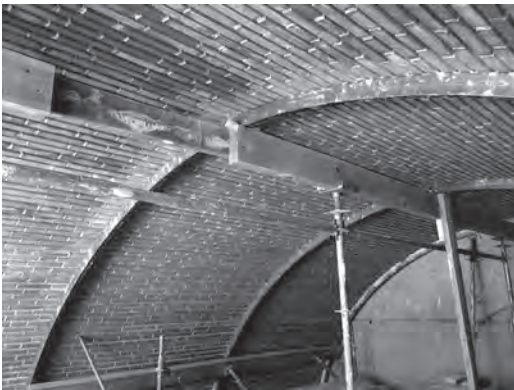
Figura 15 Vista interior de los medios de apoyo provisional y replanteo. Se aprecian las cimbras formadas por dos reglas curvadas, y las vigas de madera bajo las cabezas de las mismas y las sujeciones para aliviar el empuje en la zona inferior. Foto: C. Martín
