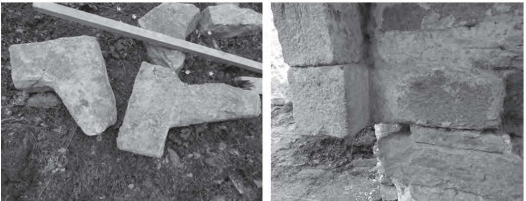
Figura 11 Piezas de unión que traban la hoja exterior e interior de los accesos en arco de la Casa-palacio (Imagen: D. Luengas-Carreño)
