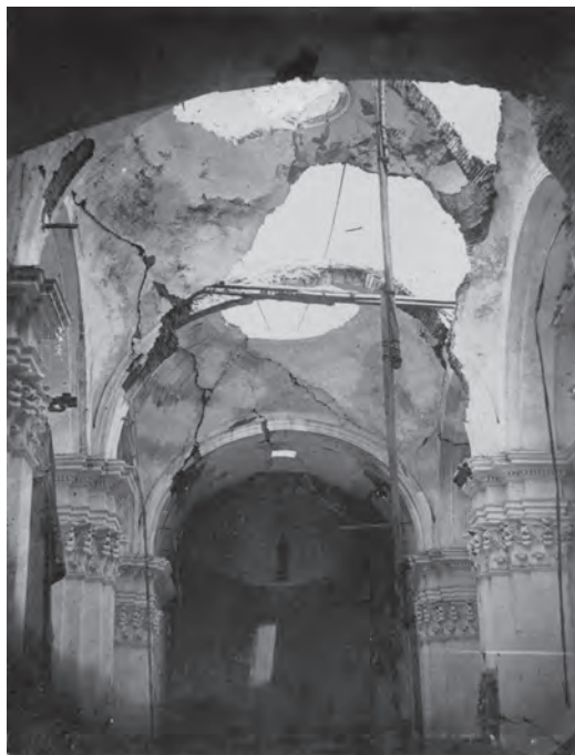
Figura 4 Quito, iglesia del Carmen Alto, cúpulas colapsadas, terremoto de 1868 (Fotografía Nacional 2018)
