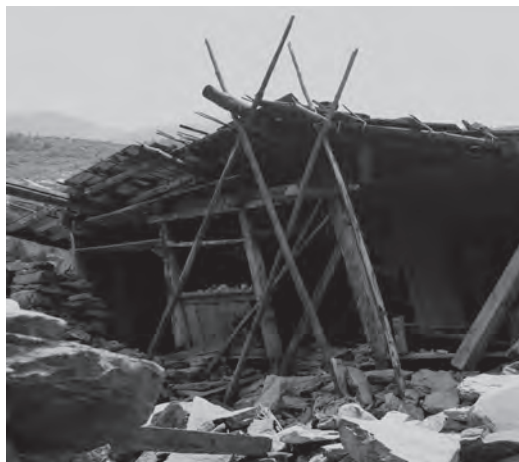
Figura 12 Foto de una vivienda dañada por el sismo del 2015 (Cedida por Beatriz López-Terradas)
