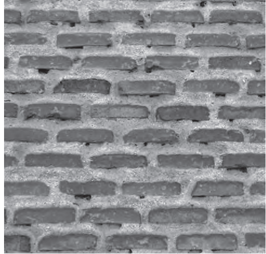
Figura 3 Fábrica con las juntas erosionadas (Autor 2009).
